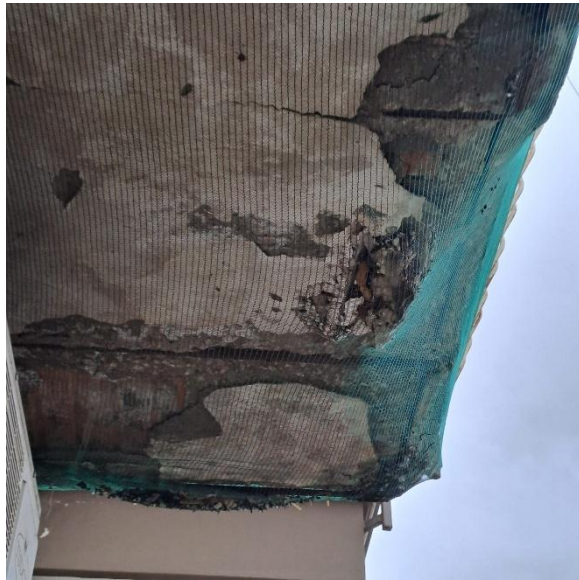
I distacchi di intonaco
